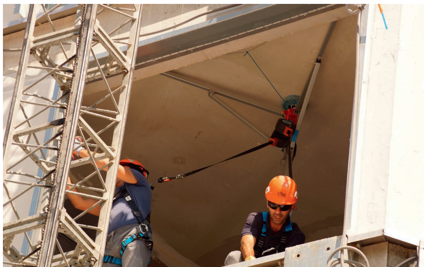
Sur chantier neuf, le SYAM permet de se sécuriser lorsque les protections collectives ont été ôtées. © SYAM
